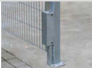
▲ Detail: Anschlusskasten mit Blechummantelung, feuerverzinkt
