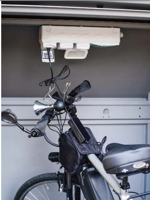
Detail: Steckdosenleiste inklusive LED-Strahler und Dämmerungsschalter
