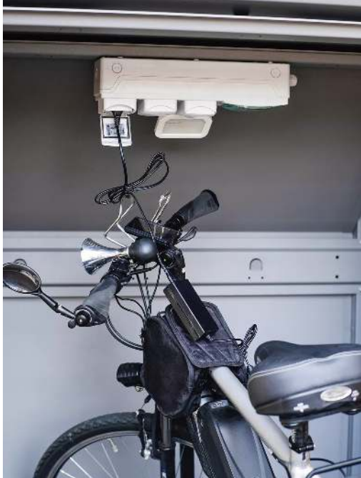
Detail: Steckdosenleiste inklusive LED-Strahler und Dämmerungsschalter
