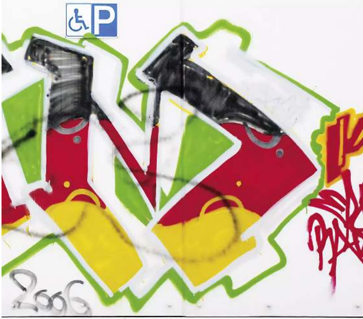
vor der Behandlung mit Graffiti-Entferner
